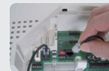
Unter der Gehäuseabdeckung steht viel Platz für die Anschlusskabel und Erweiterungsmodule (s. Seite 13) zur Verfügung.
